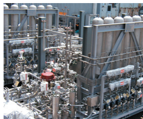
シールオイルユニット
