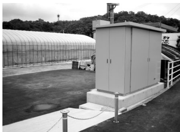
写真2 実機1号機 Photo 2 System No.1
