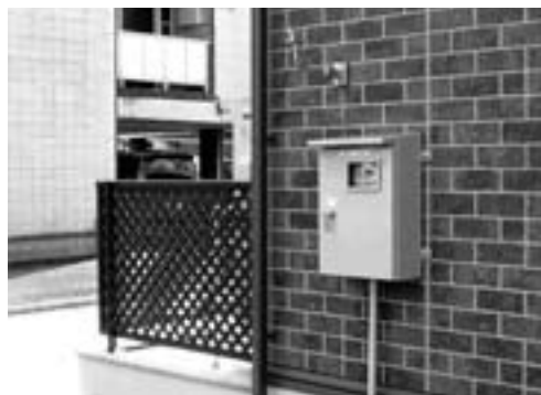
写真4 設置状況 Photo 4 Installation of control panel
