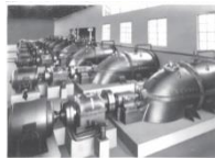
新潟県の排水機場に 納入された大型ポンプ
