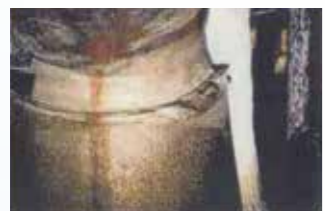
外胴ノズル部侵食写真
