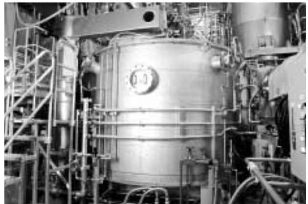
写真2 灰溶融炉 Photo 2 Ash melting furnace
