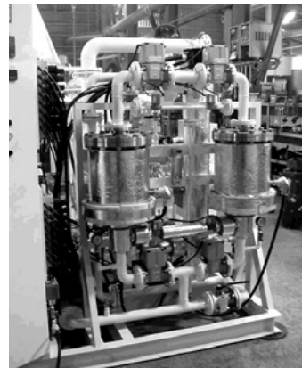
写真 シロキサン実証試験装置 Photo Siloxane removal unit
