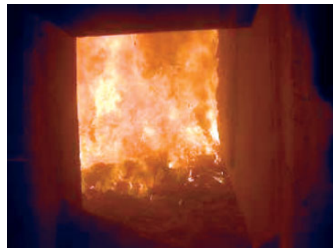
写真3 炉内燃焼状況
